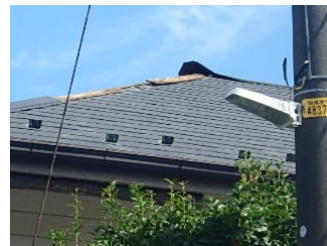
↑棟板金のめくれ
