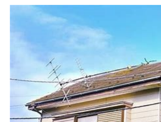
↑テレビアンテナの倒壊
