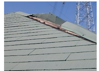
↑棟板金のめくれ
